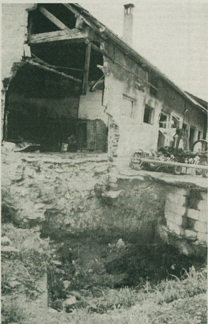
DVORIŠČE SE JE UDRLO - Na dvorišču domačije Jožeta Žagarja iz Jablane pri Mirni Peči se je že pred leti ugreznila in nastala jama se veča. Premikanje tal mogoče že ogroža stanovanjsko hišo tik ob ugreznini, česar sicer še nihče ne ve zagotovo, saj strokovnjaki še niso z vrtnanjem raziskali tal. Novomeški izvršni svet je doslej že dal denarno pomoč za popravilo, vendar je odobrenih sredstev premalo za vse nujne ukrepe. Ne da bi raziskali tla, se verjetno ne bodo lotili temeljitega popravila poškodovanih objektov, saj ne vedo, ali se ugrezanje lahko nadaljuje kljub vsem ukrepom ali se pojavi kje drugje na dvorišču. O ugrezanju dvorišča in nastali škodi pri Žagarjevih je pred časom znova razpravljal izvršni svet, katerega je na jama v Jablanu tokrat opozoril Franci Koncic, predsednik občinske skupščine. Izvršni svet je pripravil še pomagati Žagarjevim, vendar občina ne bo plačala vseh stroškov popravila in zavarovanja zemljišča. Sneg je sicer jama "saniral", vendar je v resnici videti taka, kot kaže fotografija. (Foto: L. M.)
