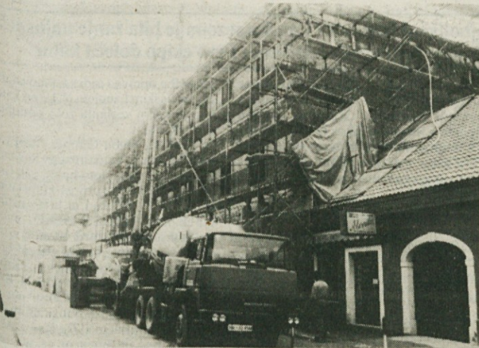
STAVBO, V KATERI BO SODIŠČE, ŠE OBNAVLJAJO - S 1. januarjem je okrogno sodišče tudi v Krškem, vendar pa zhenkrat stavbo, v kateri bo, še obnavljajo. V tej stavbi je bila sodnja tudi v stari Jugoslaviji, po predvidevanjih bo ponovno v uporabi v začetku maja, do takrat pa bodo dejavnosti okrajnega in okrognega sodišča potekale v nadomestnih prostorih. Stroški obnove znašajo 240 milijonov tolarjev. (Foto: T. Gazvoda)
