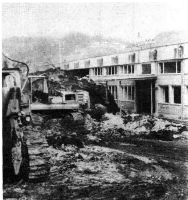
Plaz je že porušil jeseni dograjeni del Lisce (Foto: dokumentacija Lisce)
