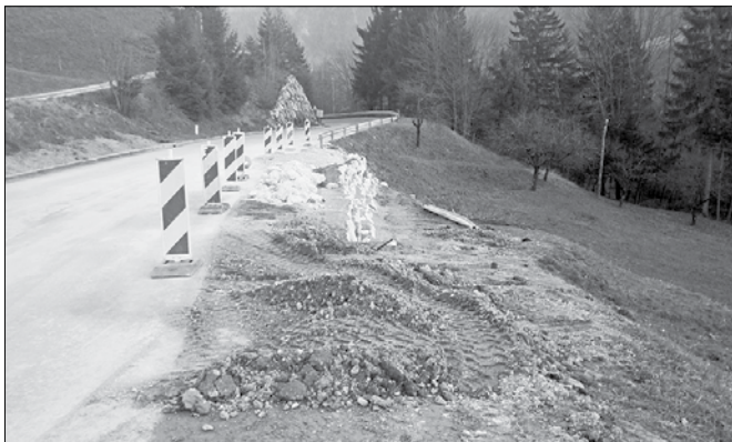
Nujna vzdrževalna dela so bila potrebna zaradi vdora cestišča. (Foto: Štefka Sem)
