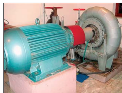
Slika 7. Mala hidroelektrarna moči 70 kW
