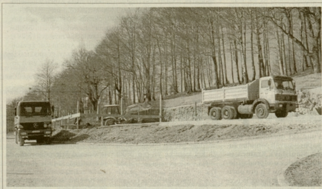
Urbanistični inšpektorji so ugotovili, da rušenje planinskega doma na Svetini ni potekalo povsem v skladu z dovoljenjem.
