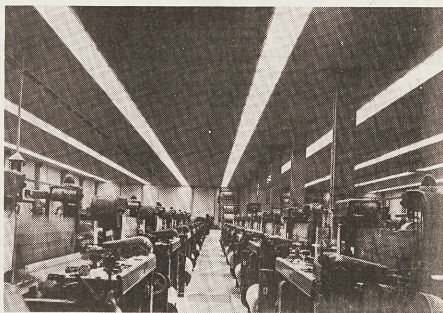
Večja storilnost v primernih delovnih pogojih: v tekstilni tovarni v Preboldu smo montirali razsvetljavo, prezračevanje in klima naprave
