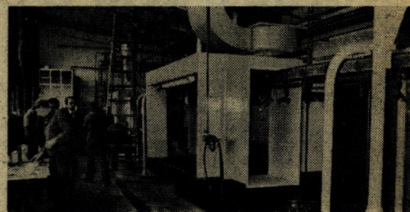
Pogled na novo sodobnejšo brizgalno kabino. V lakirnici sta postavljeni dve takšni kabini
