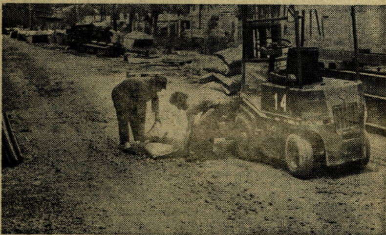
Kot vidite na gornji sliki, imamo tudi makadamsko cesto med topilnico in barvnim mlinom. Njene dokaj globoke luknje občutijo najbolj vozniki viličarjev. Kdo ve, morda se bomo »zbrihtali« in cesto popravili.
