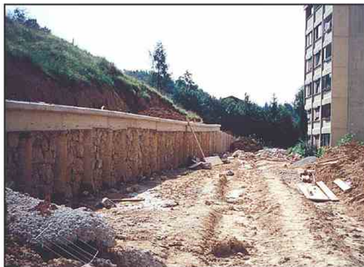
Plaz, ki je ogrožal stanovanjski blok na Gorici, bo kmalu odpravljen. Na obnovo pa še čaka nekaj večjih plazov, dva ogrožata individualni stanovanjski hiši.
