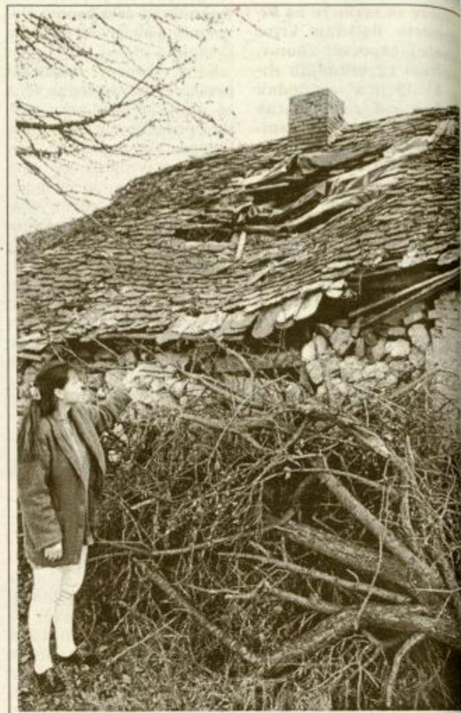
»Hiša je od gradnje drugega pasu avtoceste ostala močno poškodovana,« pravi Veronika Fevžer. »Obnoviti je ne moremo, ker je prestara, nove pa nam na tem mestu že pred leti niso dovolili zgraditi.«
