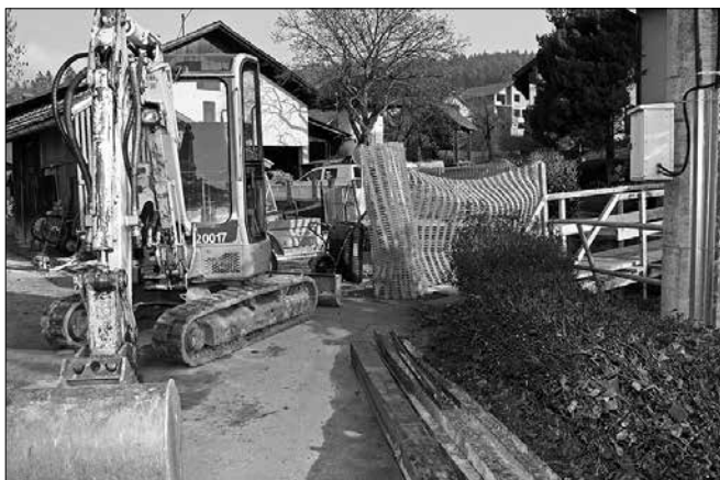
Celotna obnova mostu bo stala okoli 16.000 evrov.
