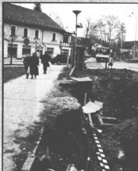
Nezaščiten jama je nevarna. Izvajalec pa - nič! (foto: A.O.)
