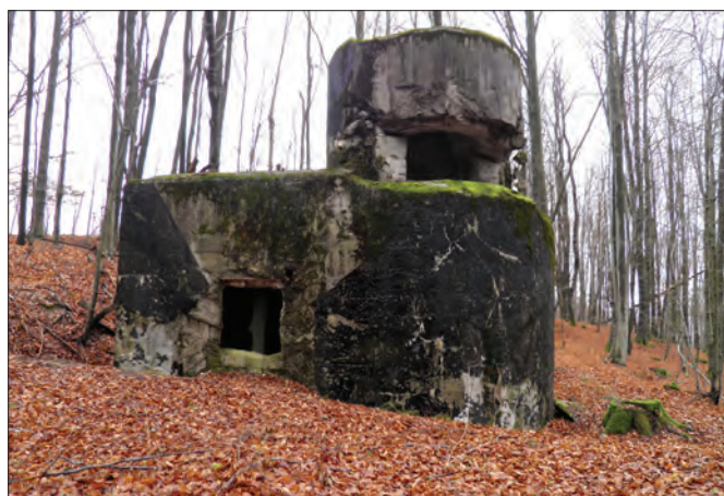
134. Mali tipski objekt na Zaplani. Nasut bi moral biti do višine hidroizolacijskega premaza (Matevž Grošelj 2014).
