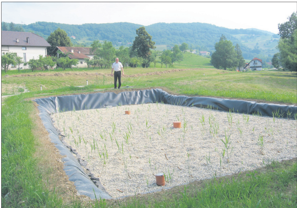
Pred nekaj dnevi je na Trebčah za del vasi začela delovati prva rastlinska čistilna naprava v občini Bistrica ob Sotli. Trebče so v zaščitenem Kozjanskem parku in na območju Nature 2000.
