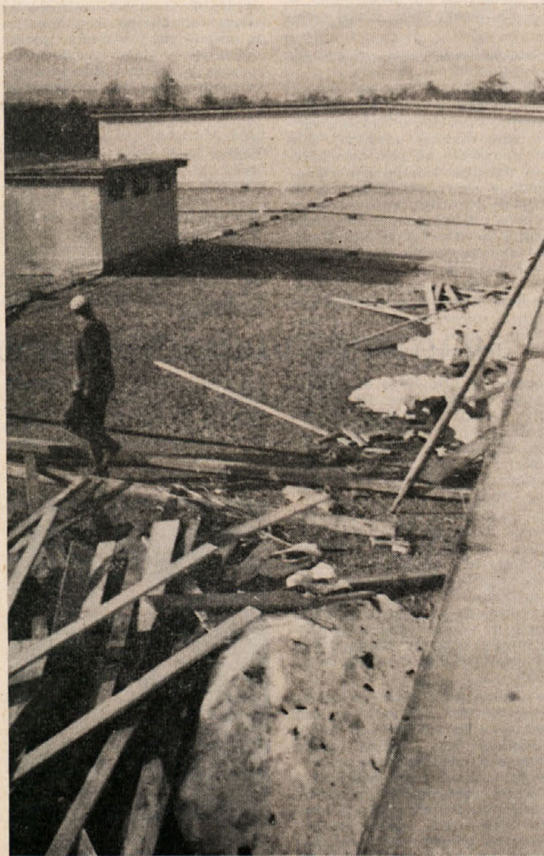
Slika dovolj zgovorno govori o našem gospodarjenju z materialom. Odkod in zakaj toliko lesa na že izgotovljeni strehi? Ali ni tako ravnanje tudi povod in vzrok za kasnejše zamakanje in popravila?
