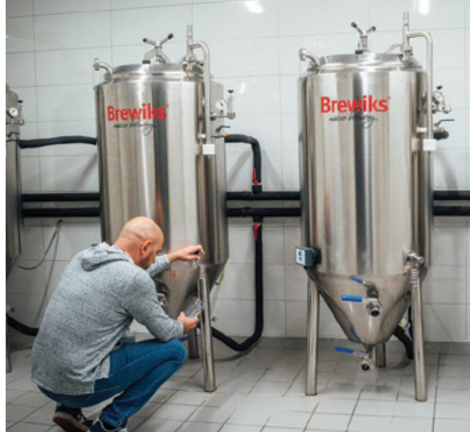
Vrelni/zorilni tanki v novi pivovarni (Foto: R. Kot)
