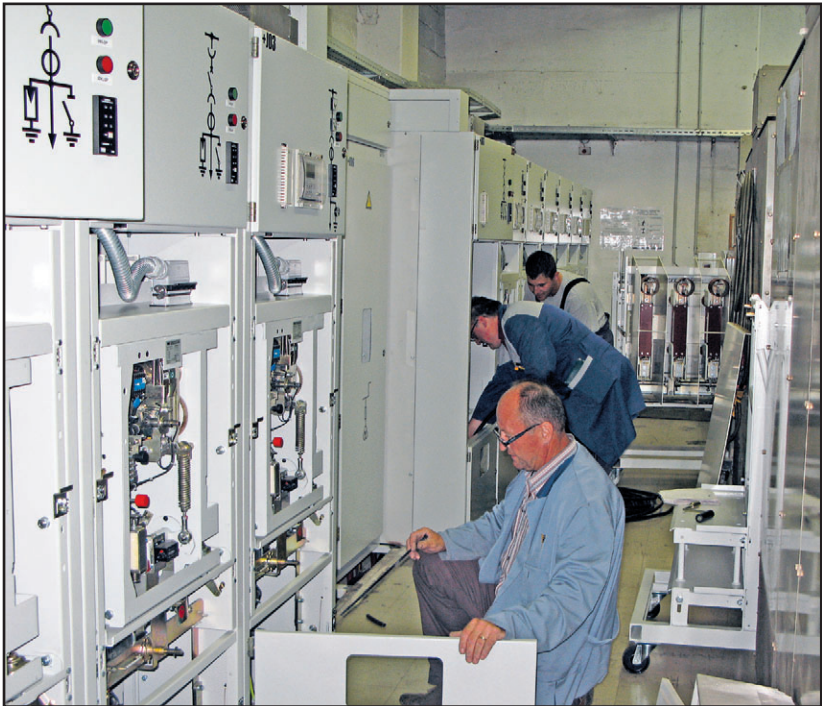
Posodobili so med drugim razdelilno transformatorsko postajo.
