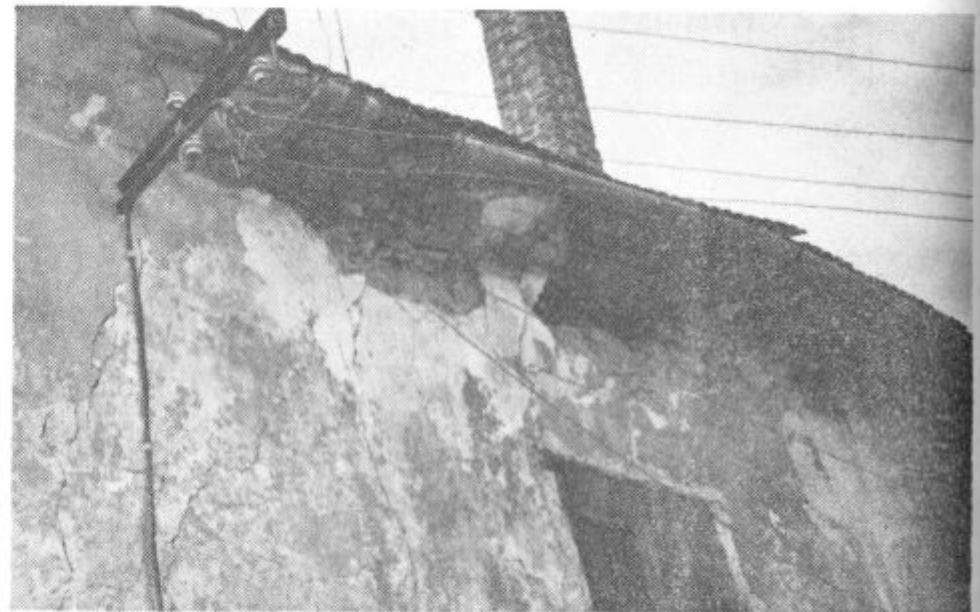
Stropni napušč pred vhodom v garažo s traktorji se lahko slej ko prej zruši in zasuje traktorista
