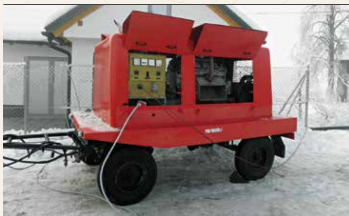
Črpališče vode v Zapotoku je napajal agregat.
