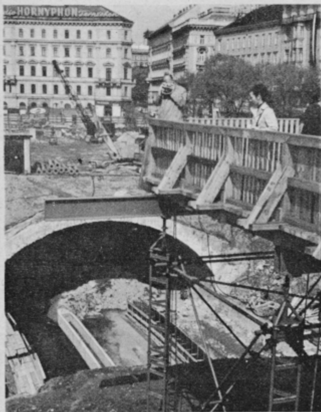
Dunaj je neprestano gradbišče. Vsako, ki je nekoliko bolj pomembno, dobi zbadljiv nadimek. Tole je na primer »Jonassgrotte«, oziroma gradnja velikega križišča za podzemeljsko železnico.
