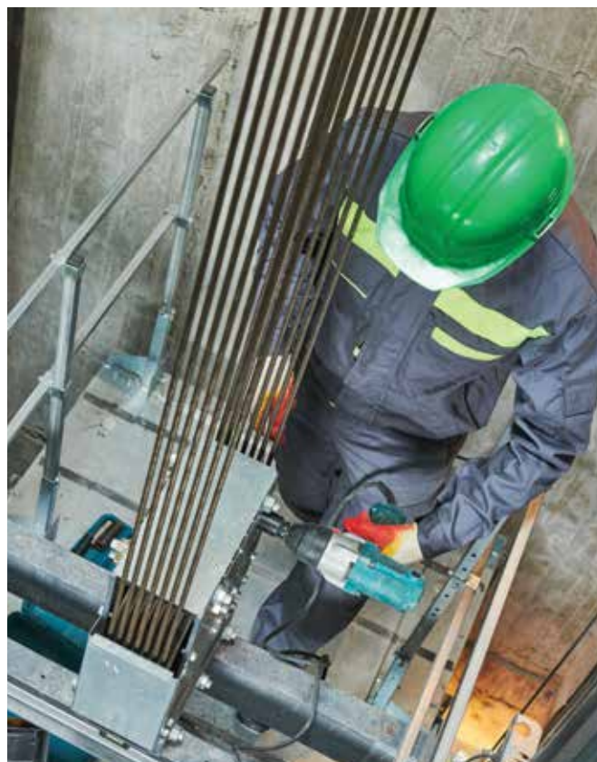
Slika 2: Ustrezno vzdrževanje dvigala je nujno in ključno za zagotavljanje zanesljivega delovanja in varne uporabe.
