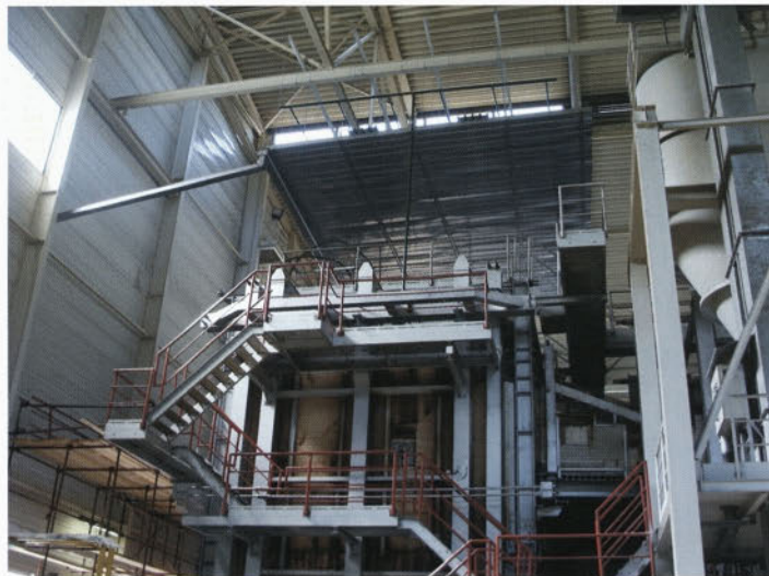
Slika 4: Streha iz Inoxa nad regeneratorji s sistemom polivanja strehe, spodaj dva dodatna obroča okrog kovinske konstrukcije regeneratorjev.
