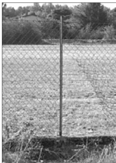
Vreča s cigaretami (zgoraj) ter luknja v zidu in mrežni ograji, ki sta ju za sabo pustili tatovi
