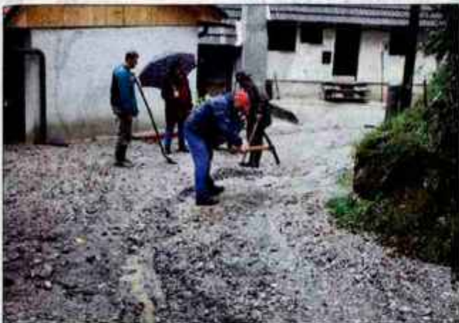
Deroča voda je uničila cesto na Taboru.
