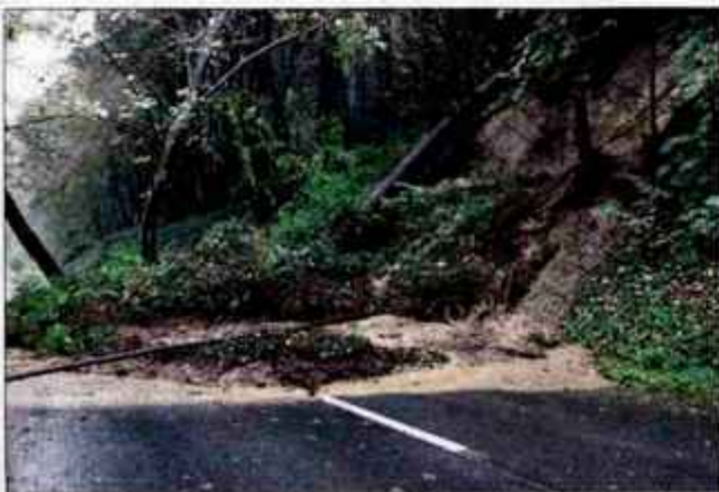
Zemeljski plaz je zaprl cesto pri Posavcu.
