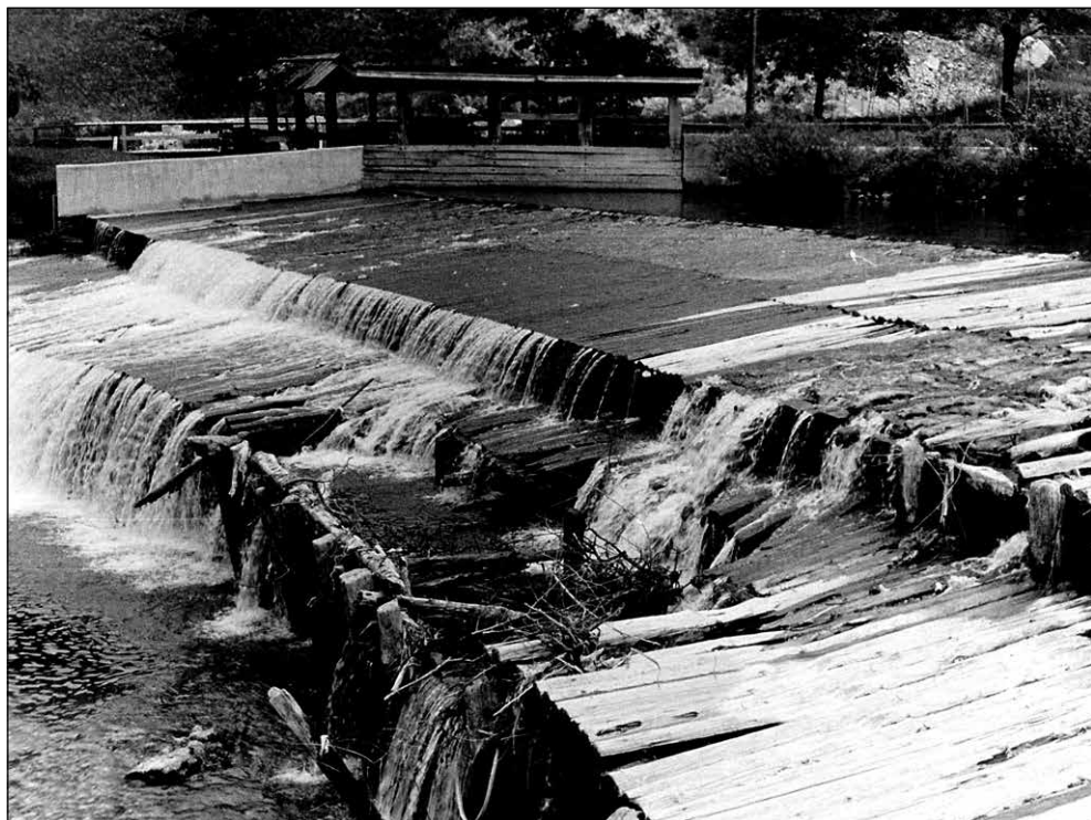
Leto 1964, pogled na močno poškodovan lesen Dermotov jez, v ozadju zapornice za bajer v Palnado.
