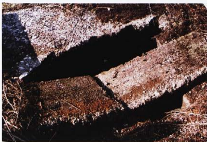
Grajski vodnjak, globok okoli 38 m, "zavarovan" z zlomljeno betonsko ploščo. Foto: Jože Pavlič.
