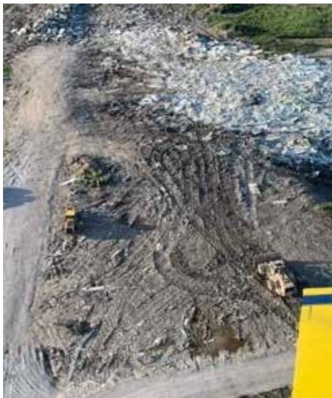
Slika 5: Razgradnja vetrne elektrarne po zaključku njihovega obratovanja je vprašanje, kateremu se njihovi investitorji trmasto izmikajo, a). Najpogosteje jih nerazgrajene zakopljejo v zemljo b).
