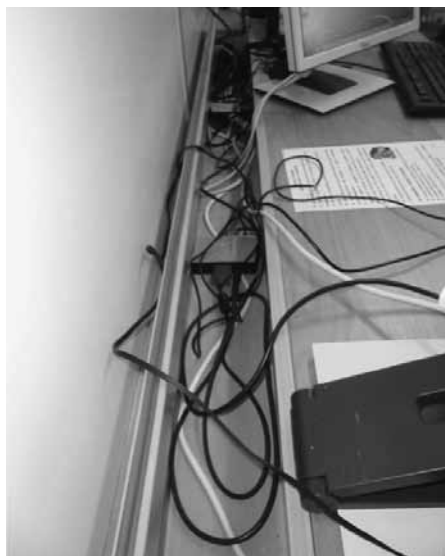
Slika 4: Kanal, v katerem so kabli in odjemalci.
