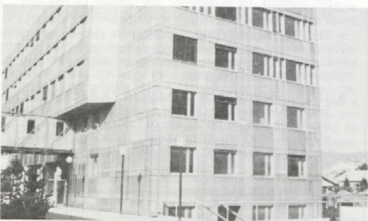
Objekt »TEHNIČNO TEHNOLOŠKA PRIPRAVA PROIZVODNJE«, investitor JEDINSTVO. Na objektu so še zaključna dela — montaža opreme in pohištva.
