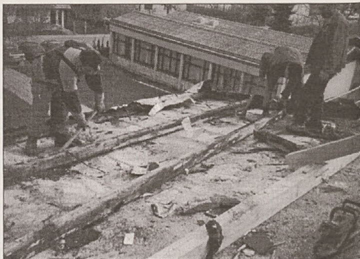
Posledice slabo izvedenega dela so presenetile celo gradbenike!
