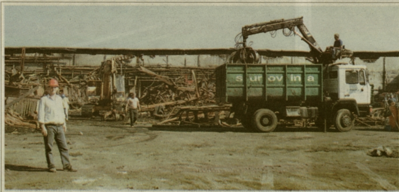
Delavci odstranjujejo železje, ki je ostalo po požaru. Na tem mestu naj bi kmalu zrasla nova hala.
