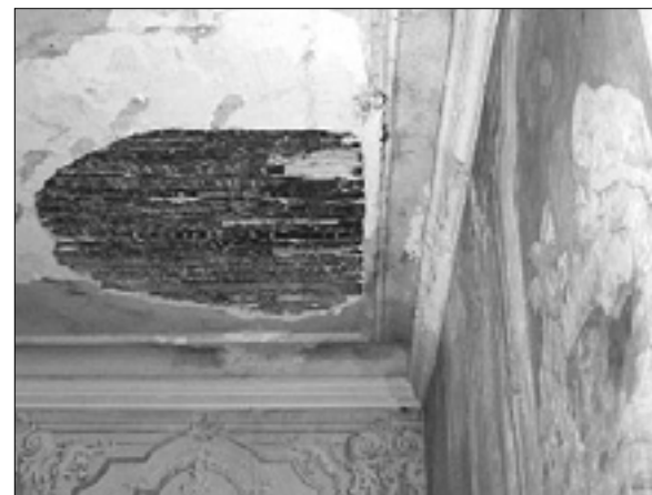
Zaradi obilnega dežja je voda začela curljati v notranjost
