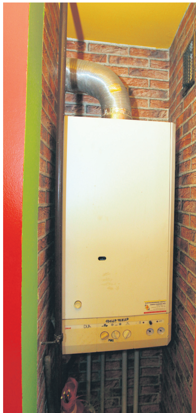
Po oceni dimnikarjev se kar 80 odstotkov ljudi, ki se ogrevajo s plinom, ogreva na stare plinske peči z notranjim vlekom, ki so lahko smrtno nevarne.
