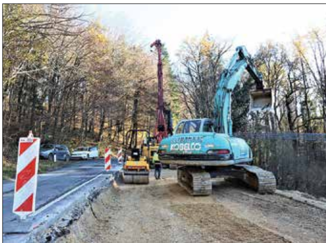
Izvajalci podjetja Slemenšek d.o.o. v teh dneh sanirajo večkrat poškodovano cesto pod gorenjskim klancem.
