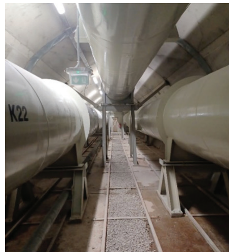
Slika 27. Cevovodi v predoru.
