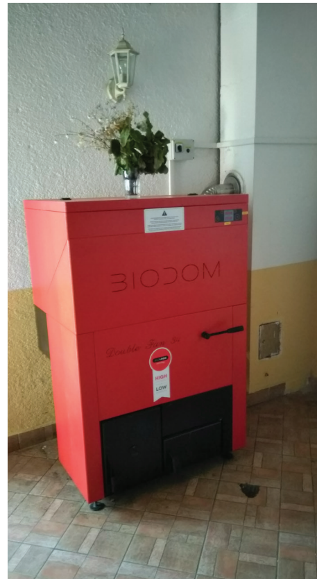
Nova peč na pelete za ogrevanje dvorane v Gradu
