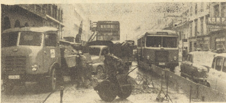
Na Titovi cesti v Ljubljani se je pogreznila zemlja, kar je terjalo dodatna dela pri graditvi kolektorja
