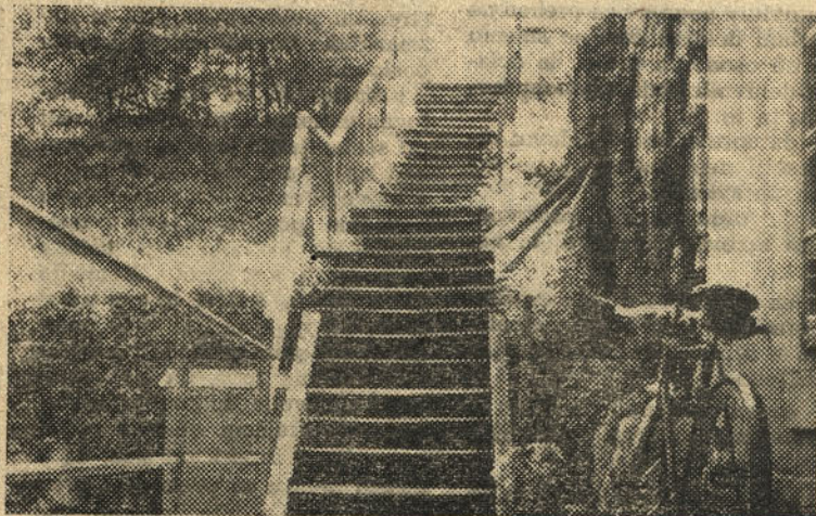
Ograja, na desni je sicer že popravljena. Kaj pa izgled?
