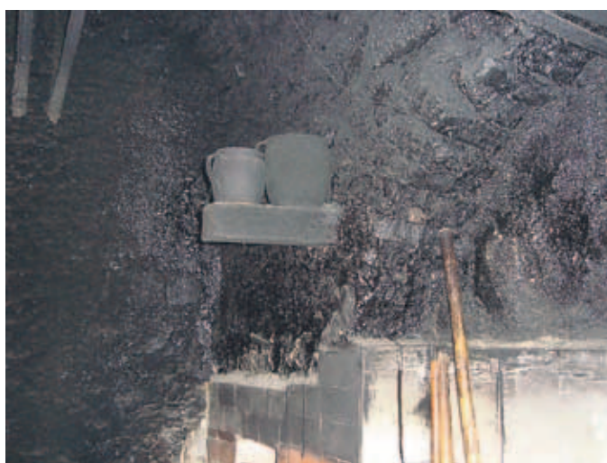
Na stenah črne kuhinje so se nabirale saje, ki so se sčasoma zelo oprijele zidu in celo zoglenele.
