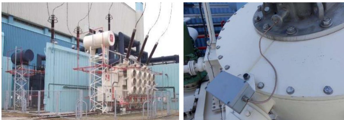
Slika 11: Glavni transformator GT1 (levo) in izvedba meritve napetosti skozi skoznik faze C na glavnem transformatorju GT2 (desno)
