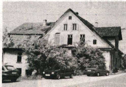
Hiša, ki že pada na cesto.
