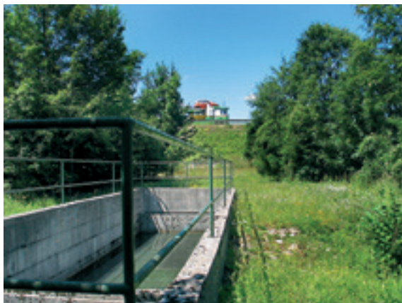
Slika 42: Odsek avtoceste Razdrto-Ljubljana pri Postojni in lovnik olj, v katerega po vsakokratnih padavinah odteka voda s cestnišča. (Foto: Janja Kogovšek.)
