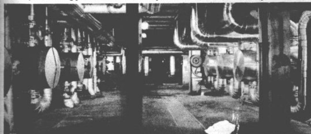
Povečanje zmogljivosti v centralni energetska postaji Velenje od 42 MW na 91 MW v letu 1979
