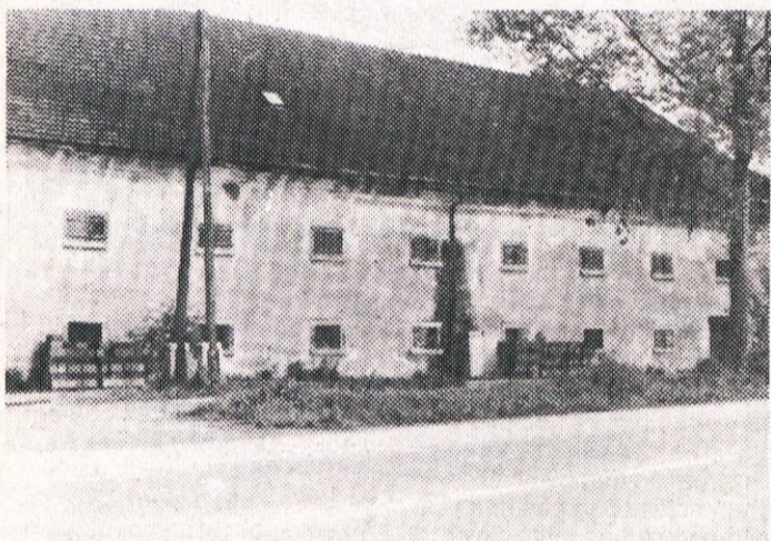
Nekdanje vojaško skladišče, sedaj pa skladišče pohištva, pa kar razpada in razpada, del gradbenega materiala pa neusmiljeno čaka mojstra;
