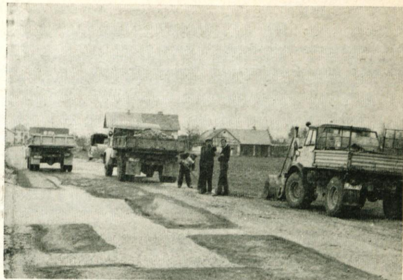
Letošnja zima je močno poškodovala vsa cestišča. Popravila počasi napredujejo, pa še to je le za silo rešitev. Z zaplatami cestišč ne bomo zaščitili
