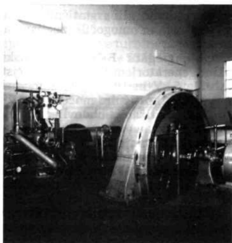
Notranjost elektrarne v »Skalcah«
