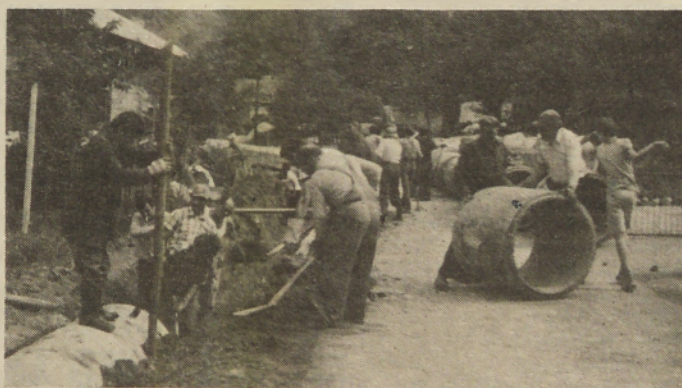
Na enem izmed območij krajevne skupnosti Gorice pri Lendavi so uredili kanalizacijo. Pri tem delu so veliko pomagali krajani. V prihodnjih letih naj bi problem kanalizacije odpravili na območju celotne krajevne skupnosti. Jani D.
