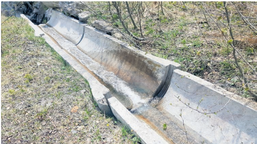
Poškodovano odvodnjavanje Macesnikovega plazu
