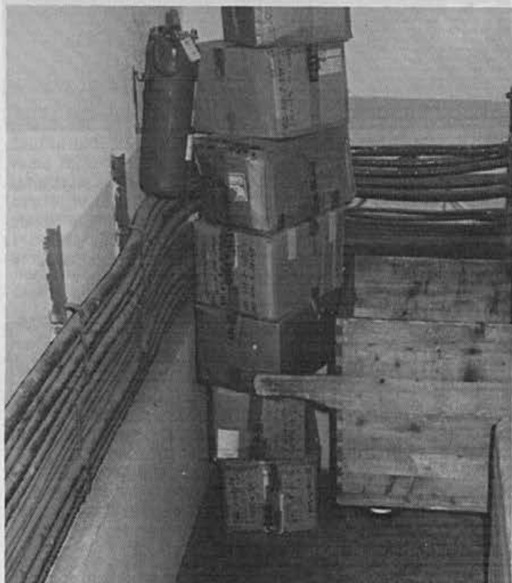
Zatrpanost v kletnih prostorih onemogoča prehod
