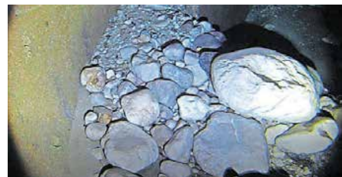
Poškodovana drenaža / FOTO: ARHIV JOSIPA MARKA SADNIKARJA
